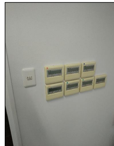
空調機は室内に7基設置
