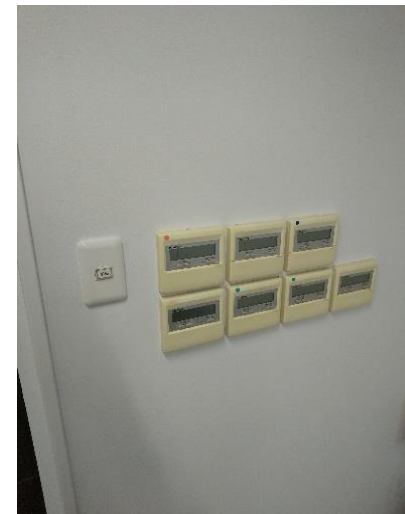
空調機は室内に7基設置
