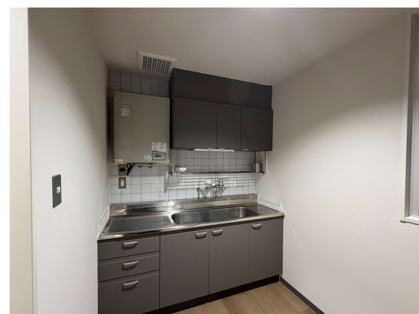
▲給湯スペース
